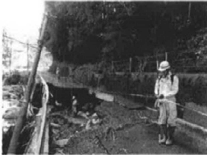
③路盤流出一部崩落 60m
